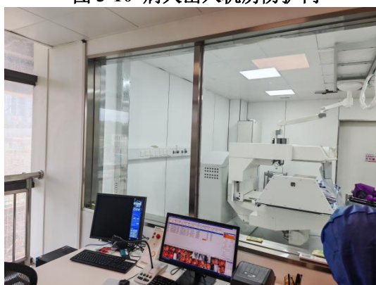
图 3-12 控制室铅玻璃观察窗
