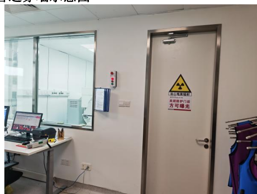
图 3-11 控制室出入机房防护门
