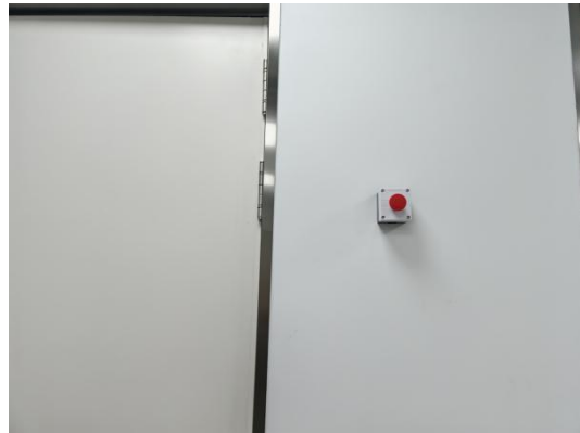
图 3-17 机房内紧急停机按钮
