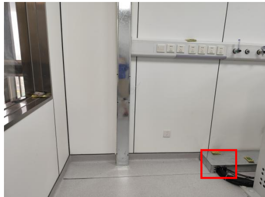
图 3-19 控制室电缆穿墙处
