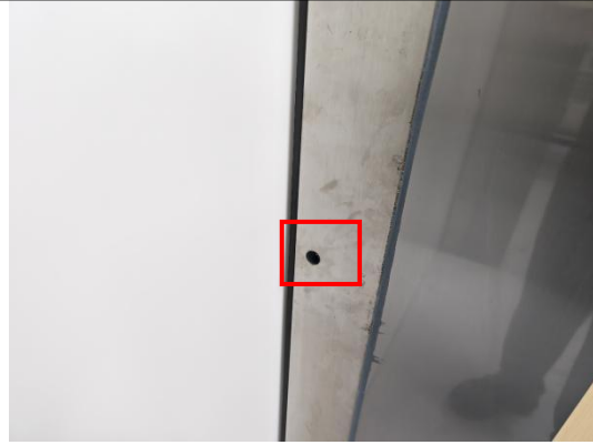
图 3-15 病人出入机房防护门防夹装置
