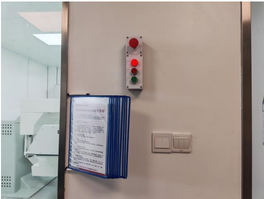
图 3-16 控制室紧急停机按钮
